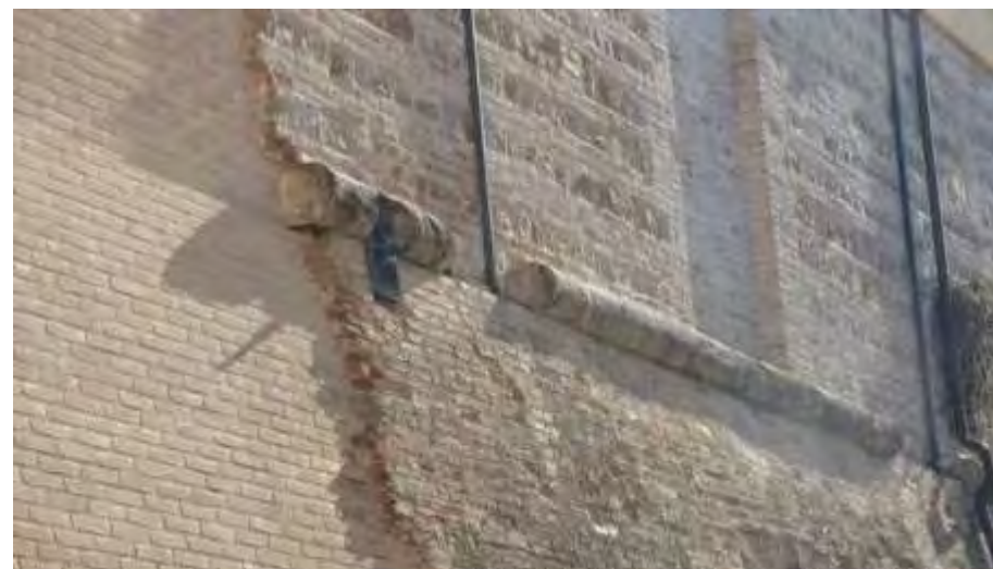
Fig. 172 - 2019 particolare del raccordo tra le mura e il nuovo arco e le chiavi di bloccaggio dei tiranti antisismici presenti in tutto il perimetro
