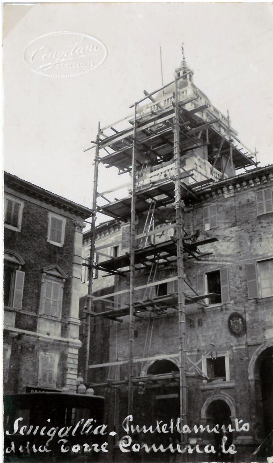
43. Senigallia: puntellamento della Torre Comunale, anno 1931 (ASCS, album n. 11, foto n. 840, Studio fotografico Cingolani Giovanni, Senigallia).
