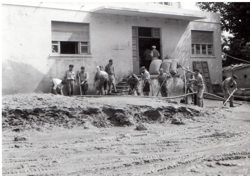
Fig. 44. Molino Olivi alla Bassa di Ripe: pompieri al lavoro di rimozione del fango. Si noti lo strato di circa 50-60 cm di fango trasportato dall'acqua di piena del fosso Porcozone che scorre sul retro dell'edificio. Due linee nere, sulle pareti a sinistra e a destra della porta d'ingresso, indicano il livello raggiunto dall'acqua: circa 2,50 m; i pompieri con pale e idranti sono all'opera di rimozione del fango prima che indurisca.
